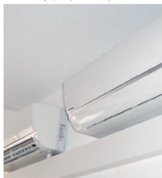
Szpital miejski w Monachium wykorzystuje w serwerowni klimatyzatory PKEA. RAC
